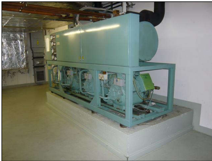
Kältemaschine R22 Baujahr 1983
